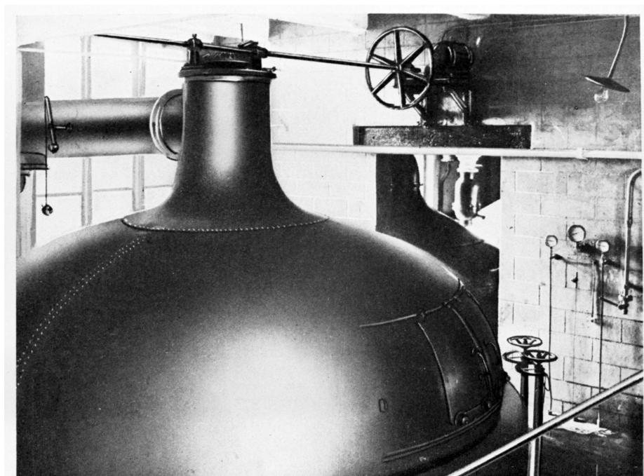
UNE DES CHAUDIÈRES DE BRASSAGE (MEURA)
