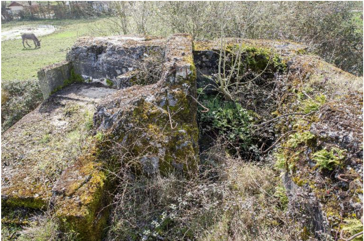
Bâtiment A : Partie explosée du toit, vers le sud-ouest
