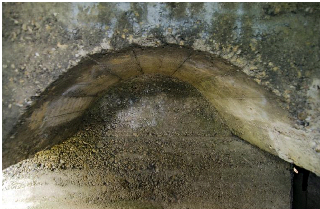
Sortie du poste d'observation. Voûte transversale, au couloir de distribution (au grand angulaire)
