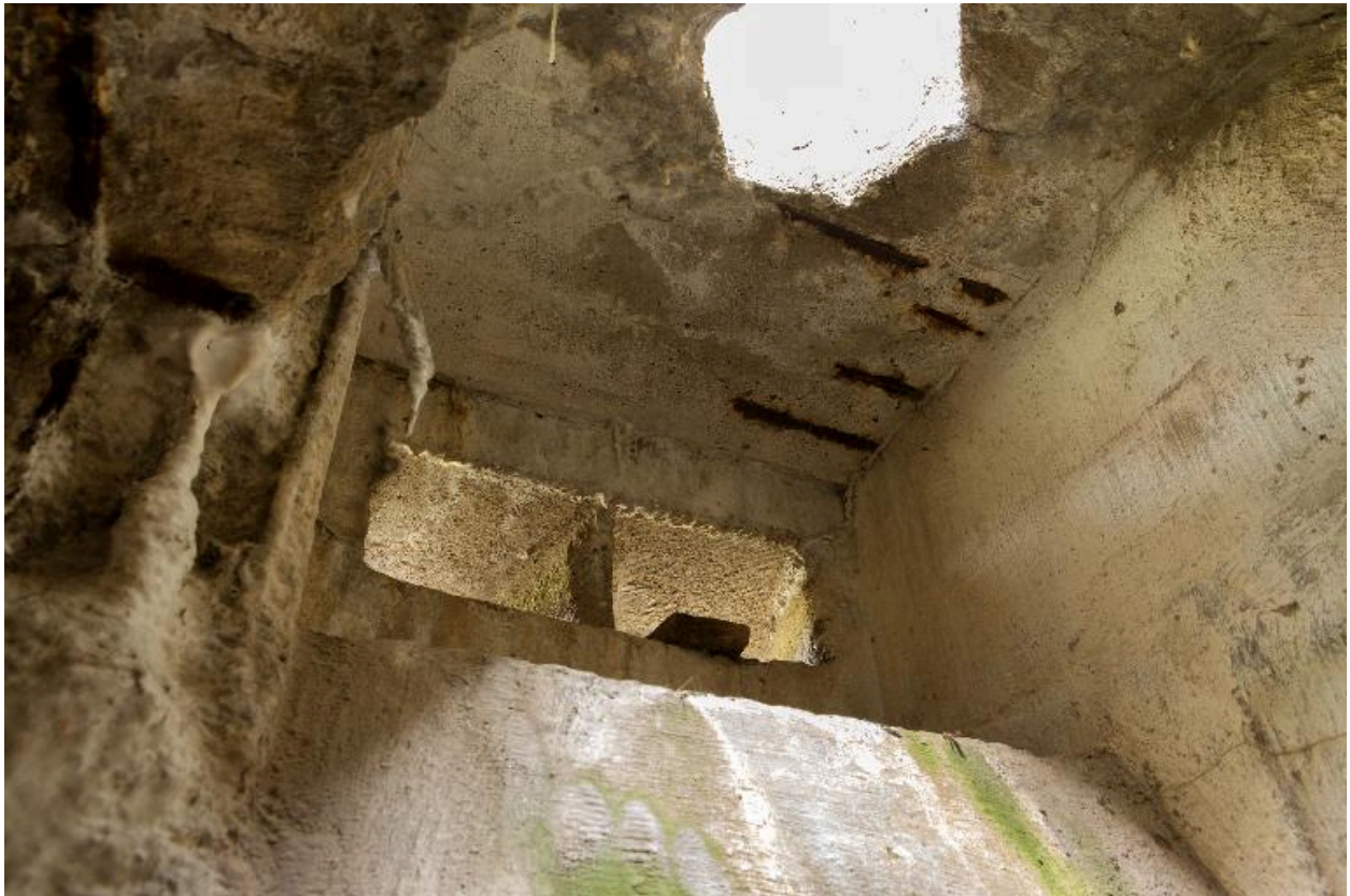
Casemate b. Vue intérieure de l'observatoire bétonné. Passage du périscopes et embrasures de surveillance, vers nord-ouest.
