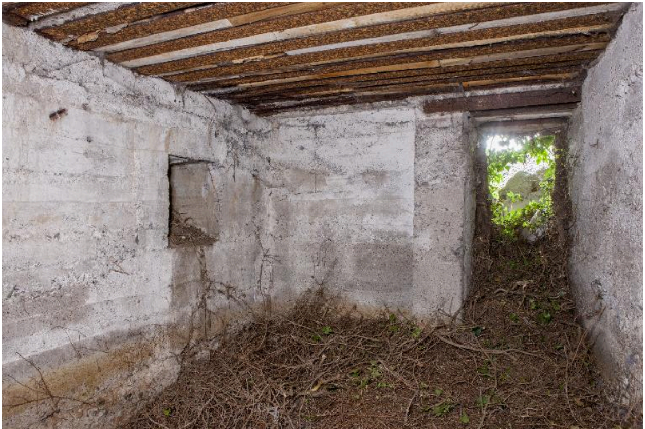
Vue intérieure de la casemate à personnel, probablement celle de la position I sur les document britanniques
