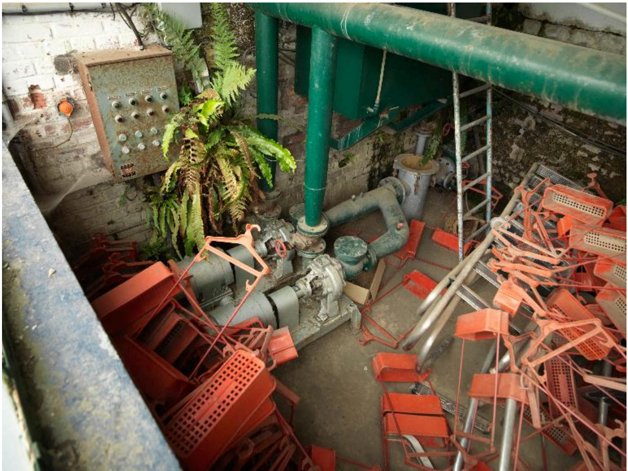
Ancien local technique sous les gradins de l'ancienne piscine : panneau de contrôle, pompes, vannes, tuyauterie et portes-habits.
