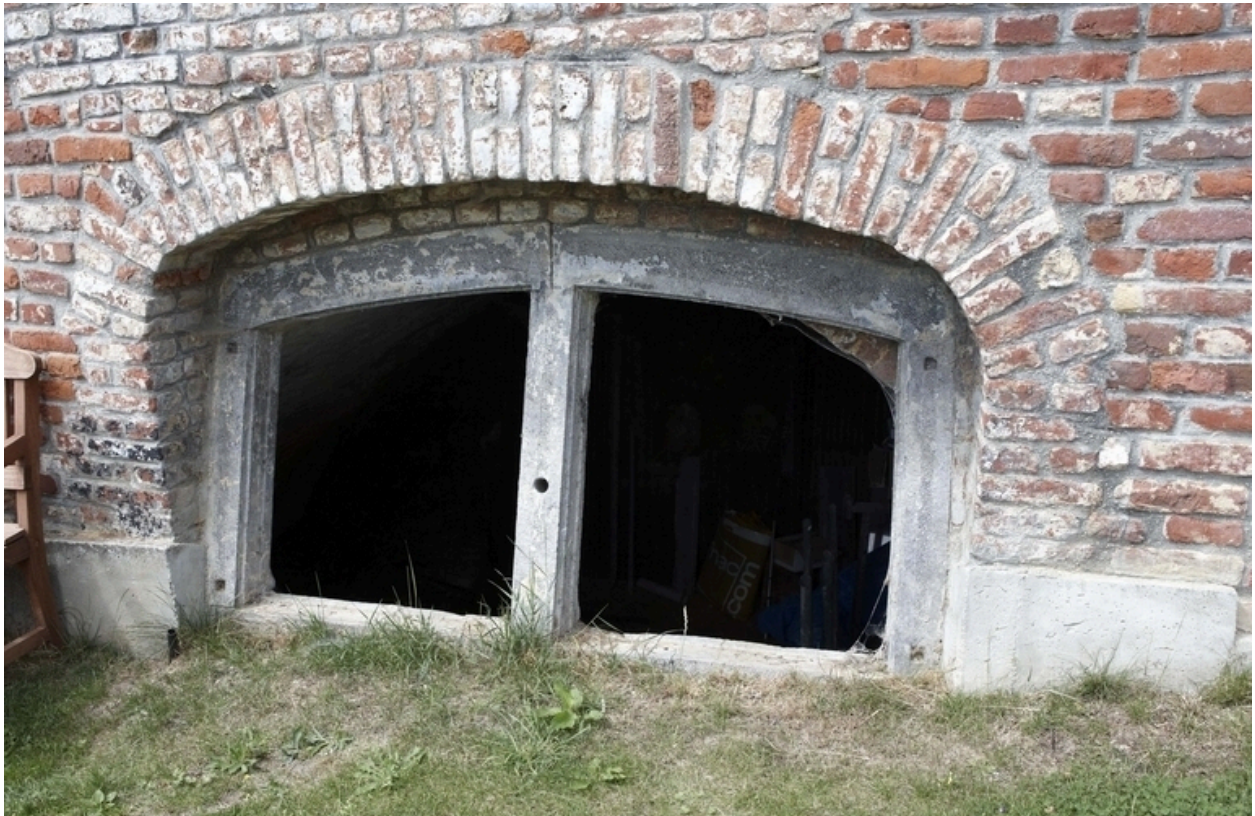
Détail d'une blocure ouverte située sur une maison (6 rue du Marais).
