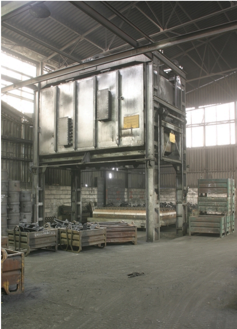
Four électrique de traitement thermique à sole mobile.
