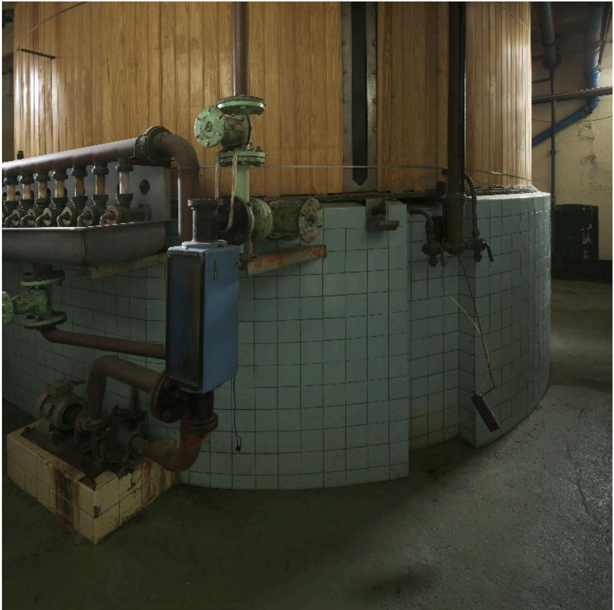
Cuve de filtration.
