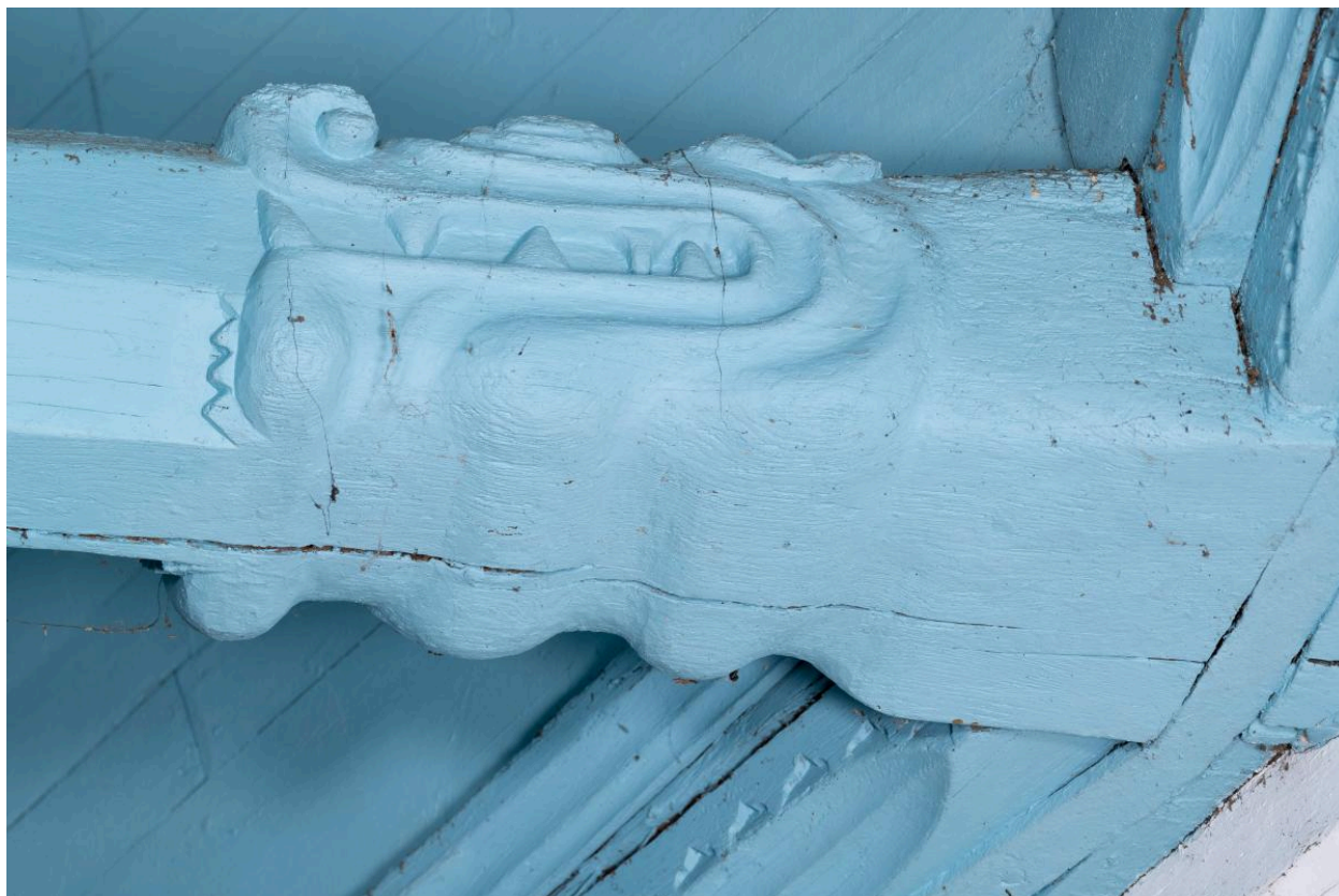
Engoulant dévorant un entrain de la charpente du chœur.
