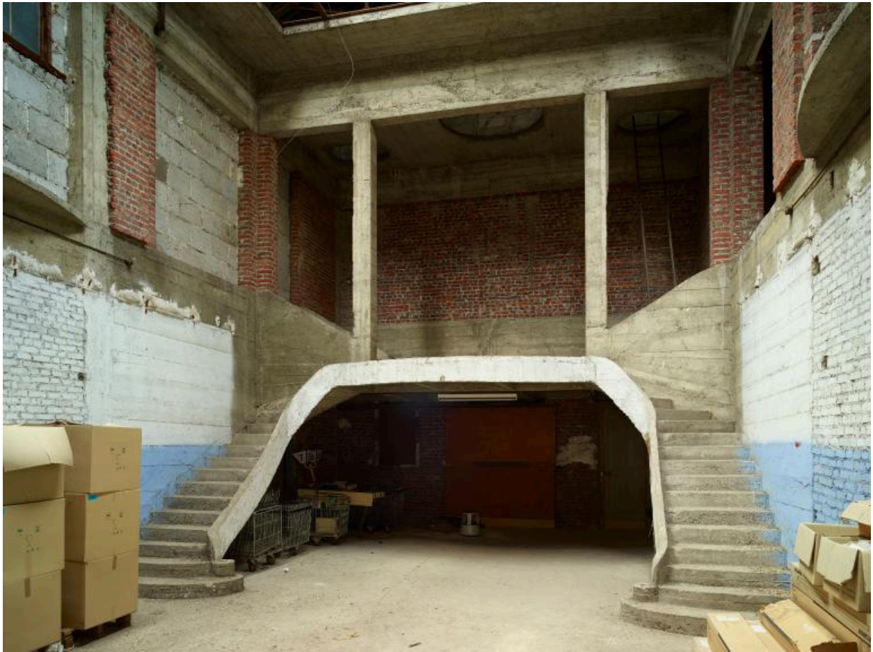
Ancienne cour à marchandises couverte donnant sur la rue Anatole-France, vue générale intérieure.
