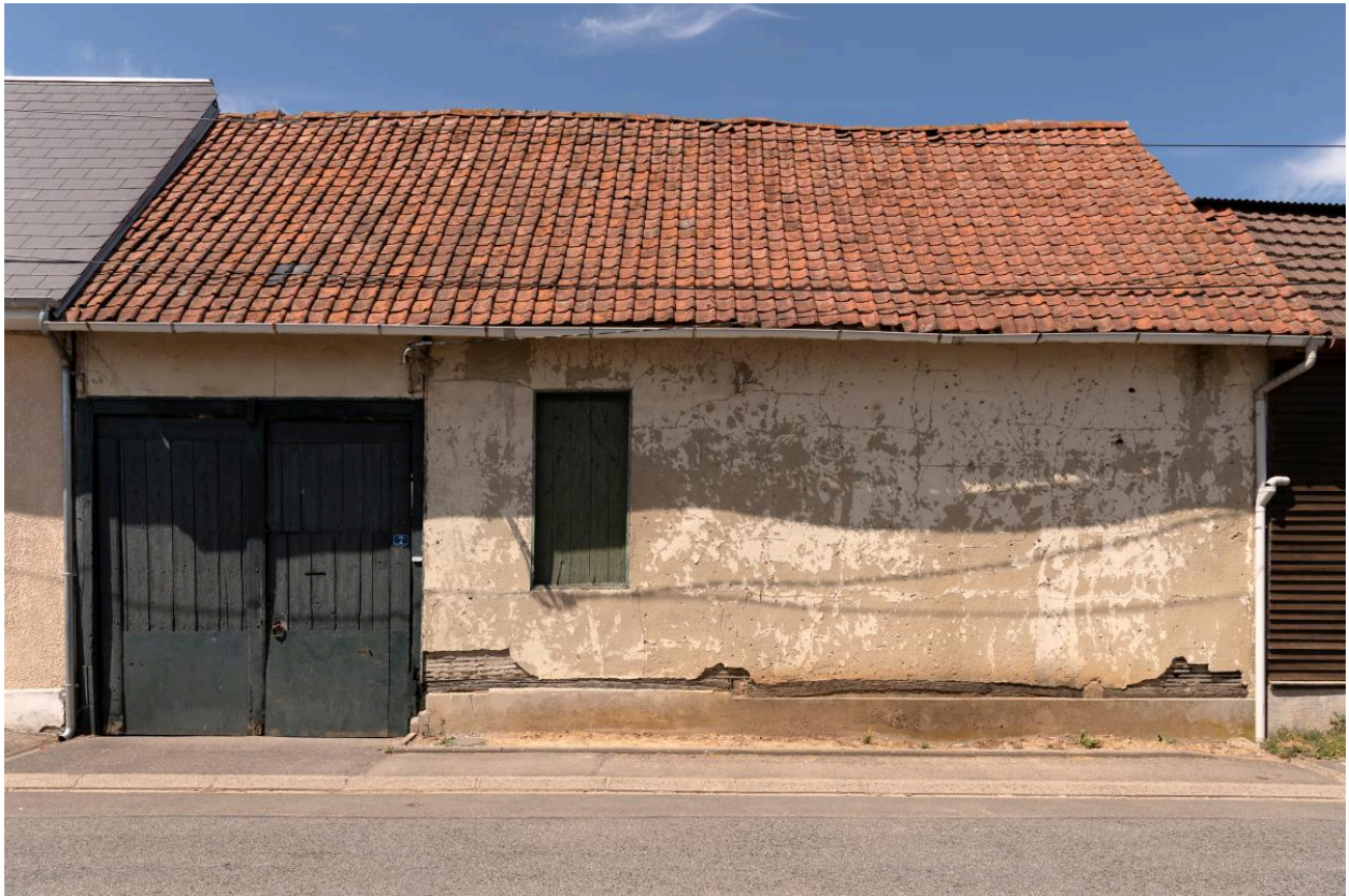
Ancienne grange sur rue avec porte à engranger, n°7 rue des Hayes, vue depuis le sud-est.
