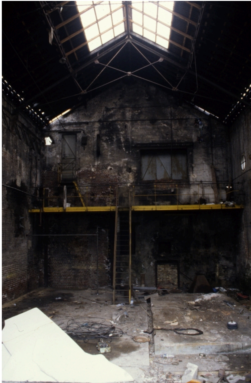
Vue intérieure de la chaufferie, 2001.
