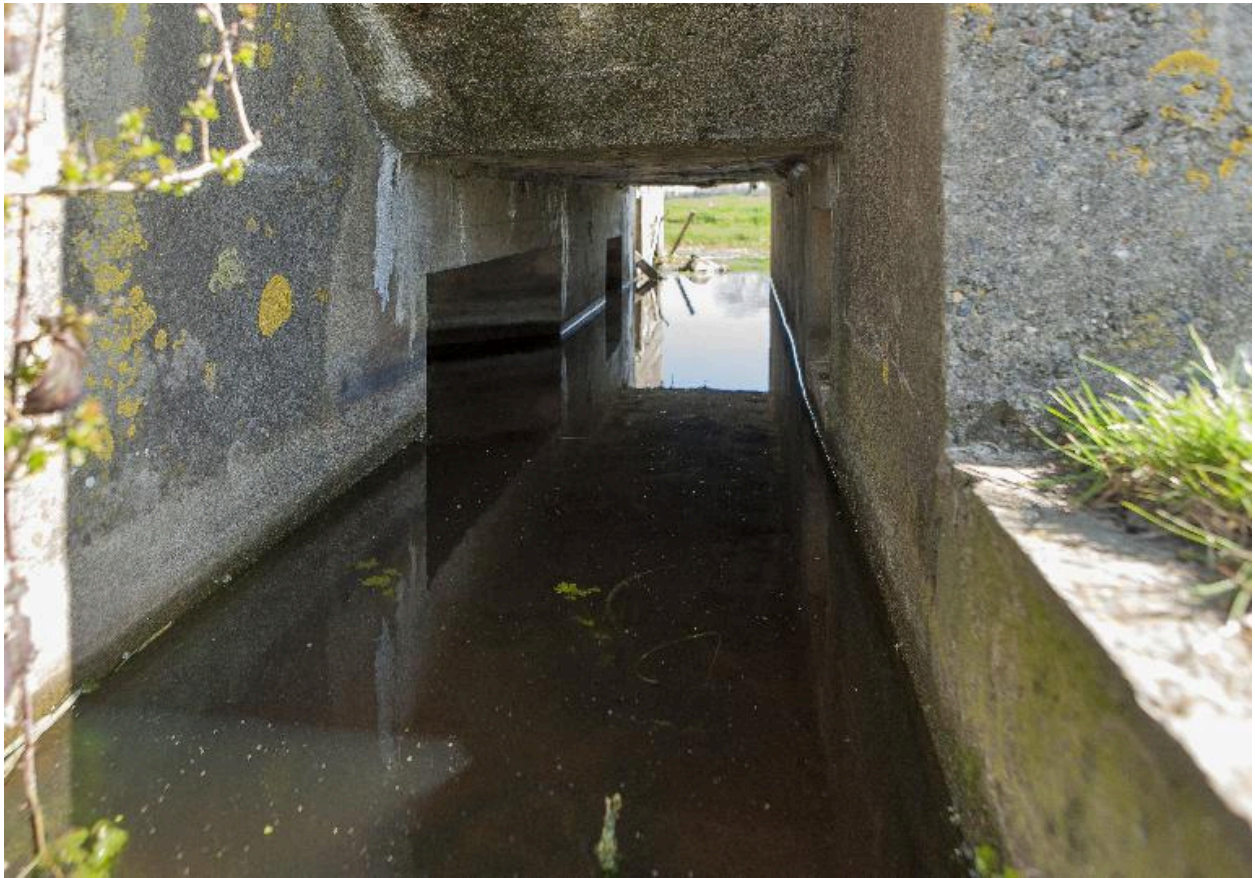
Entrée inondée sous le porche pare-souffle
