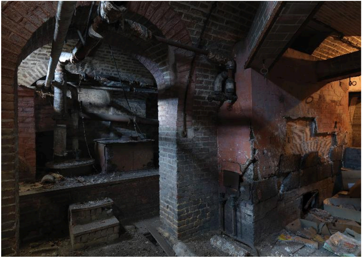
La chaudière située au sous-sol du château.
