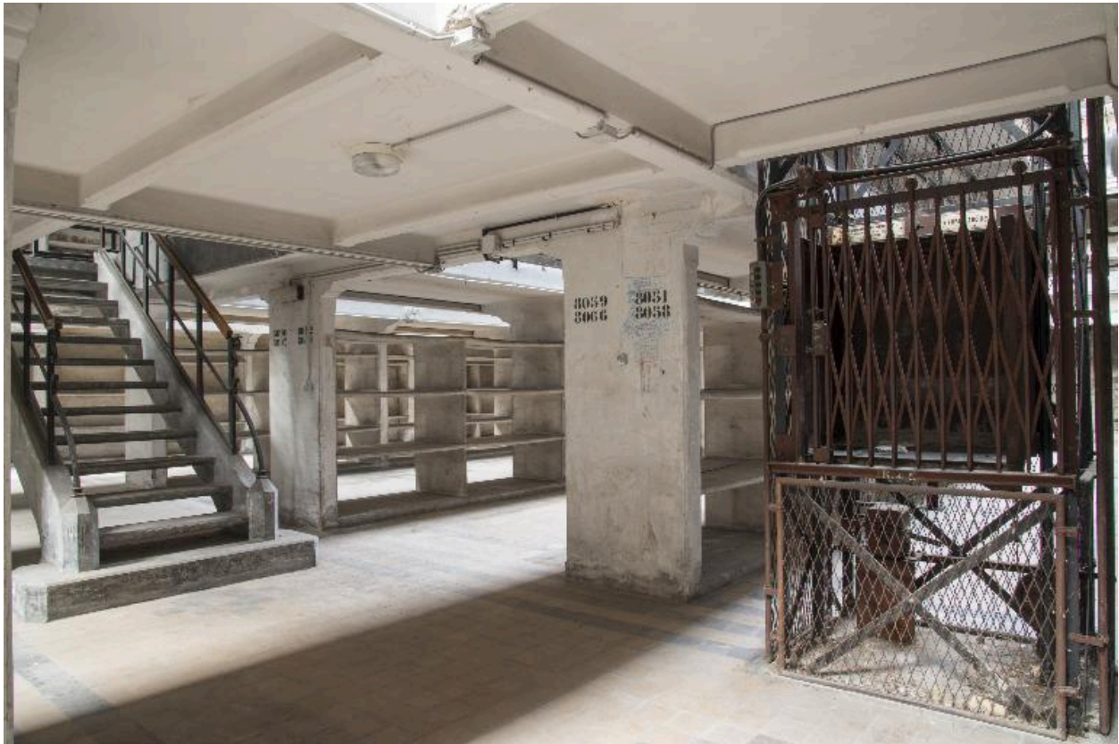
Bâtiment du dépôt, rez-de-chaussée : vue des vaisseaux 1 et 2, monte-charge et départ de l'escalier.
