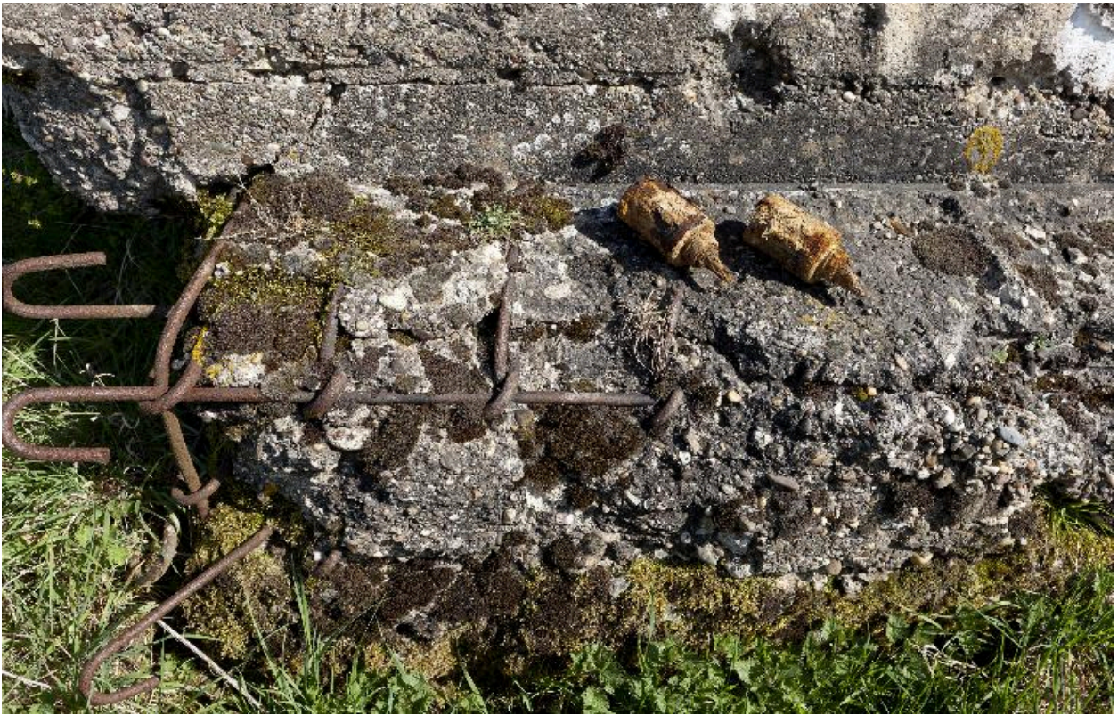
Casemate B: Elévation ouest, banquette d'infanterie (?) endommagée et grenades allemandes
