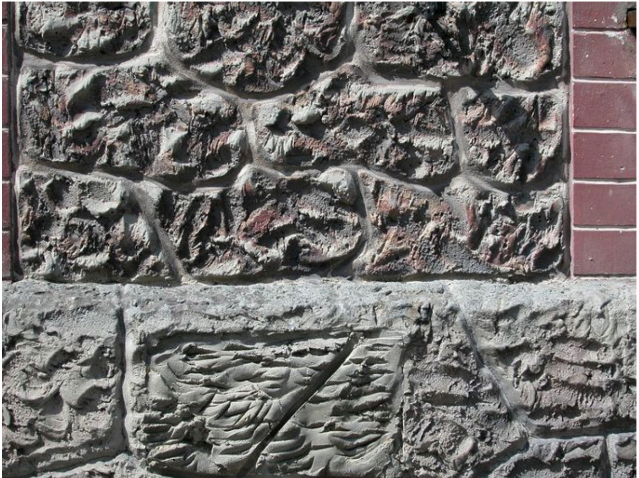
Détail de l'enduit d'imitation de la maison située 76 rue Anguier-du-Peuple (1969 AI 280).
