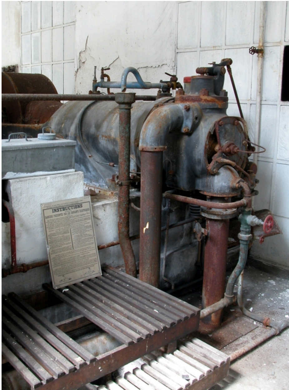
L'un des deux moteurs de la machine à gaz.
