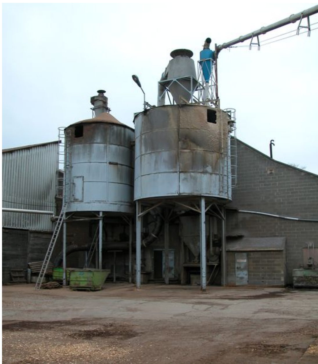
Réservoirs à sciures destinés à la chaufferie.
