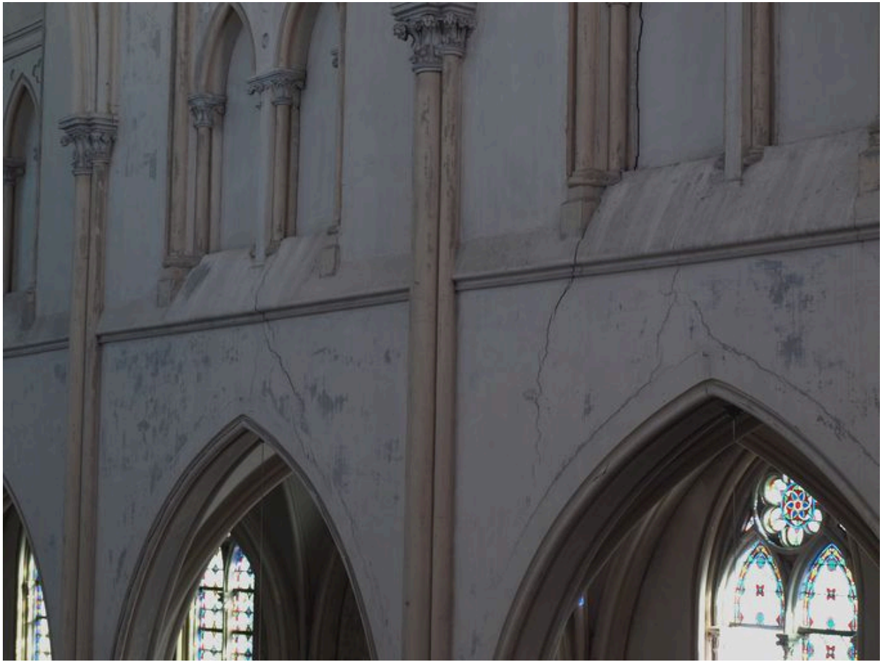
Haut des grandes arcades (mur sud de travées ouest) : fissures dans les écoinçons
