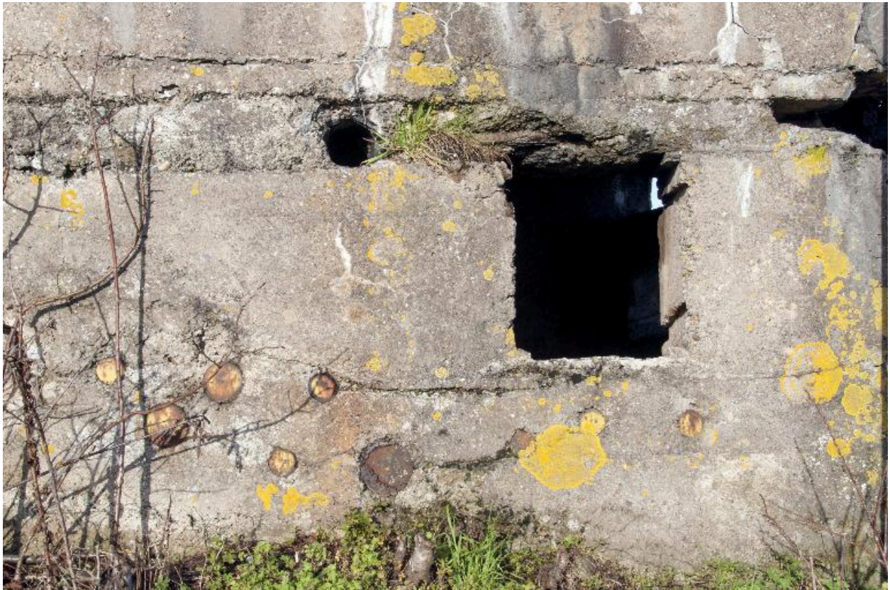
Casemate a. Inclusions métalliques à la base de l'élévation sud
