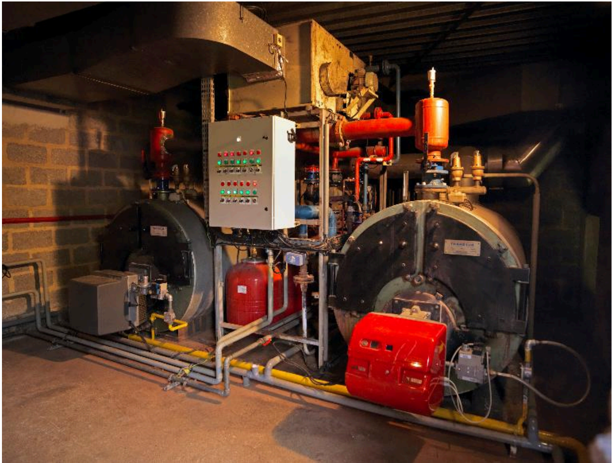
Local technique : chaudières.
