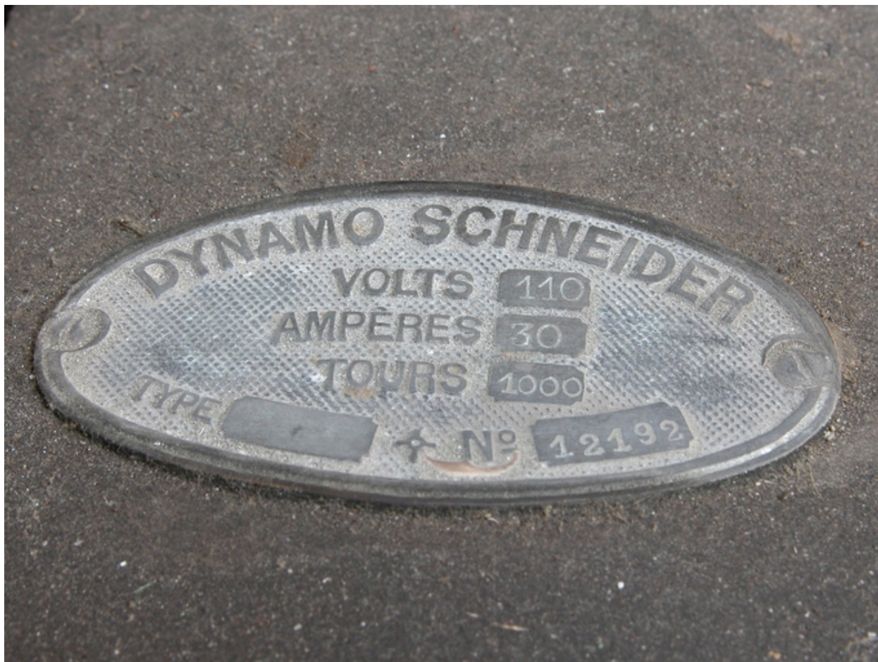
Plaque signalétique de la dynamo du générateur.
