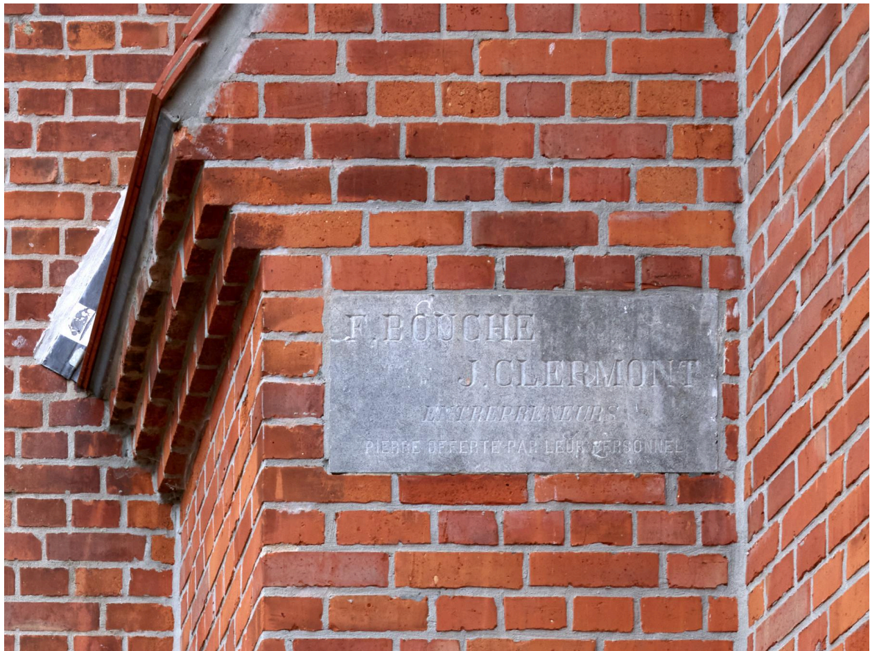
Plaque des entrepreneurs (pierre) : "F. BOUCHE / J. CLERMONT / ENTREPRENEURS / PIERRE OFFERTE PAR LEUR PERSONNEL". Localisée sur l'intrados du porche nord.
