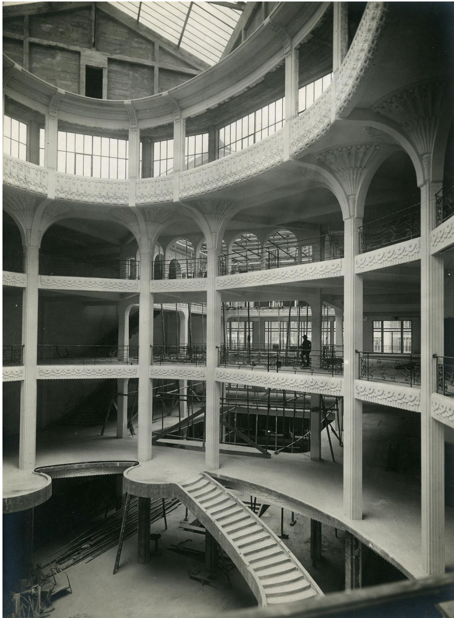
Chantier de construction de l'atrium ovale, vers 1925-1926 (Cité de l'Architecture et du Patrimoine ; fonds des Bétons armés Hennebique ; 3-D-362).
