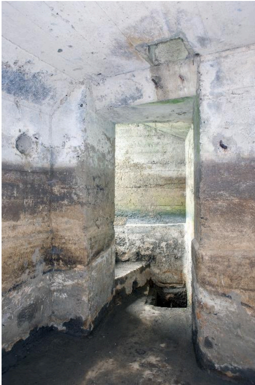
Vue intérieure de l'entrée ouest. Au sol un puisard, au plafond, le conduit du périscope
