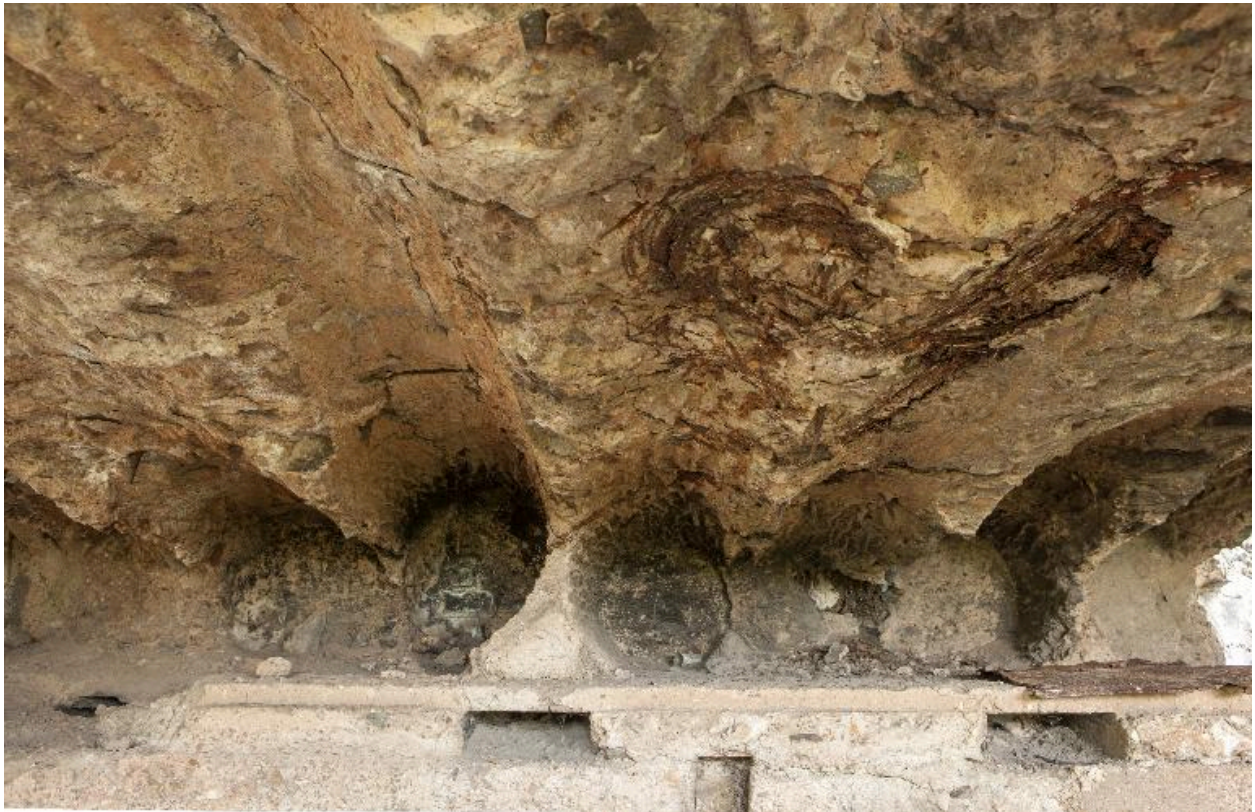
Casemate a, détail du plafond de la salle est. Empreintes des grumes utilisées lors de la construction
