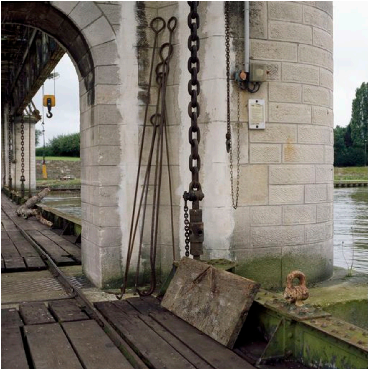
Sarron : détail d'une vannette et du système de relevage de la passerelle mobile.
