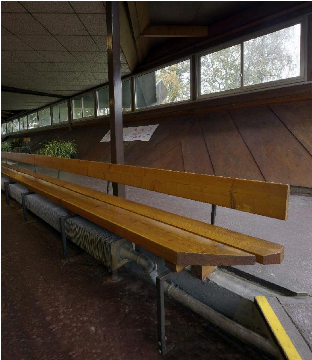
Vue de détail du système de chauffage.
