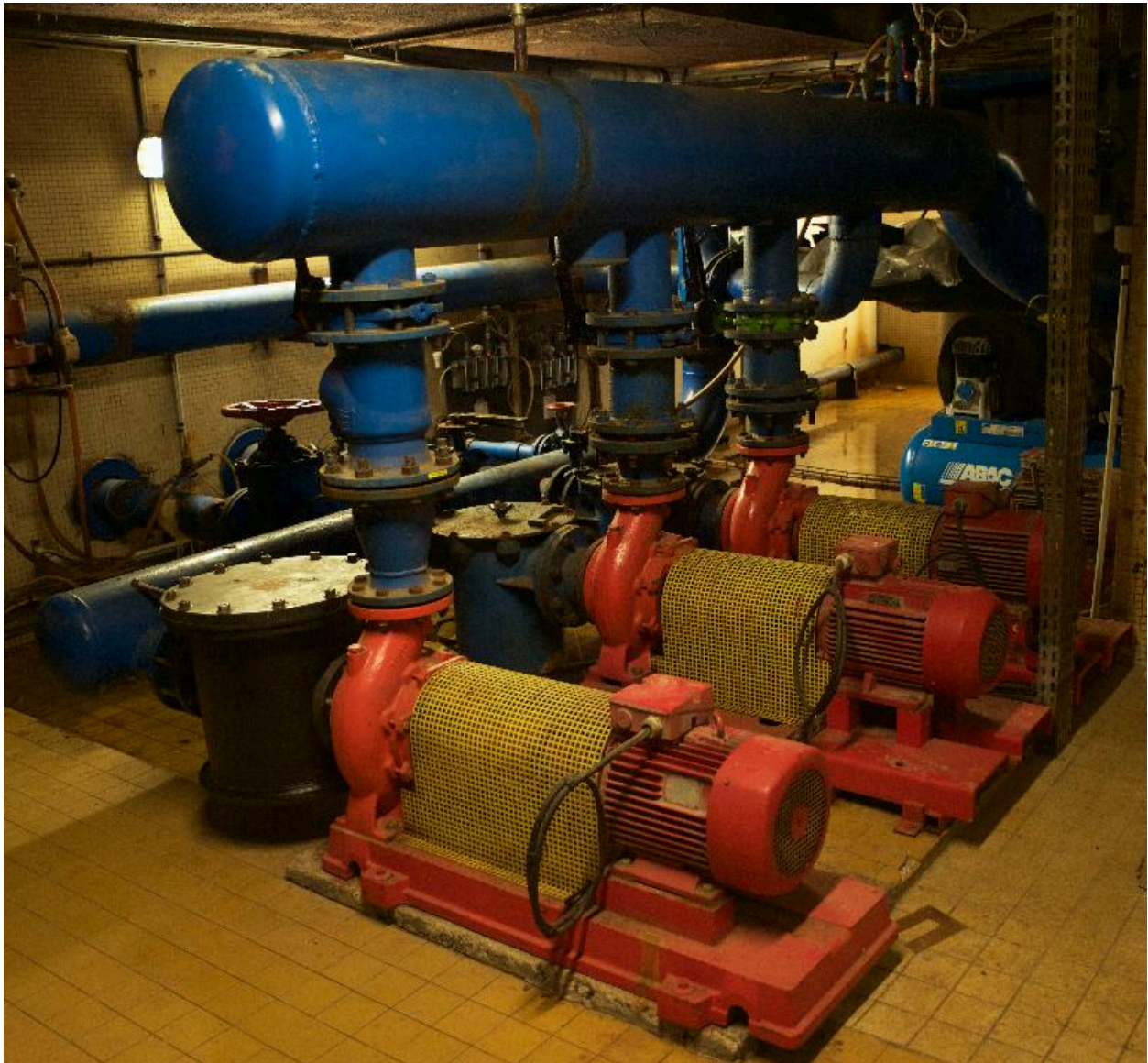
Pompes de filtration.
