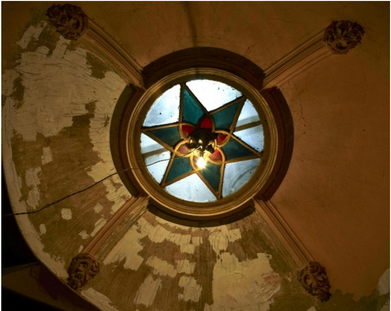
Détail de la verrière surmontant l'escalier situé dans le bâtiment abritant les pièces de réception.
