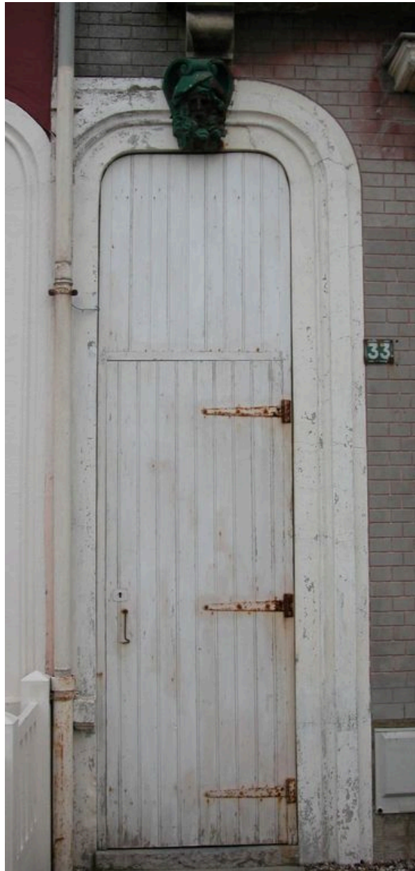
Détail de la porte de la maison dite Espana, protégée par une double porte en bois.
