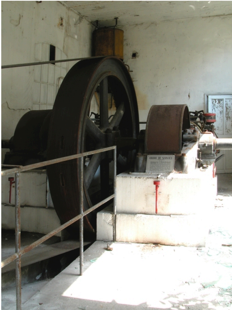
Vue générale de la machine à gaz.
