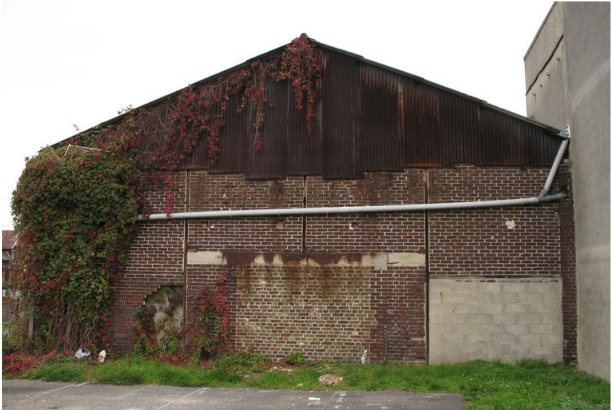
Etat du mur pignon sud-ouest en brique.
