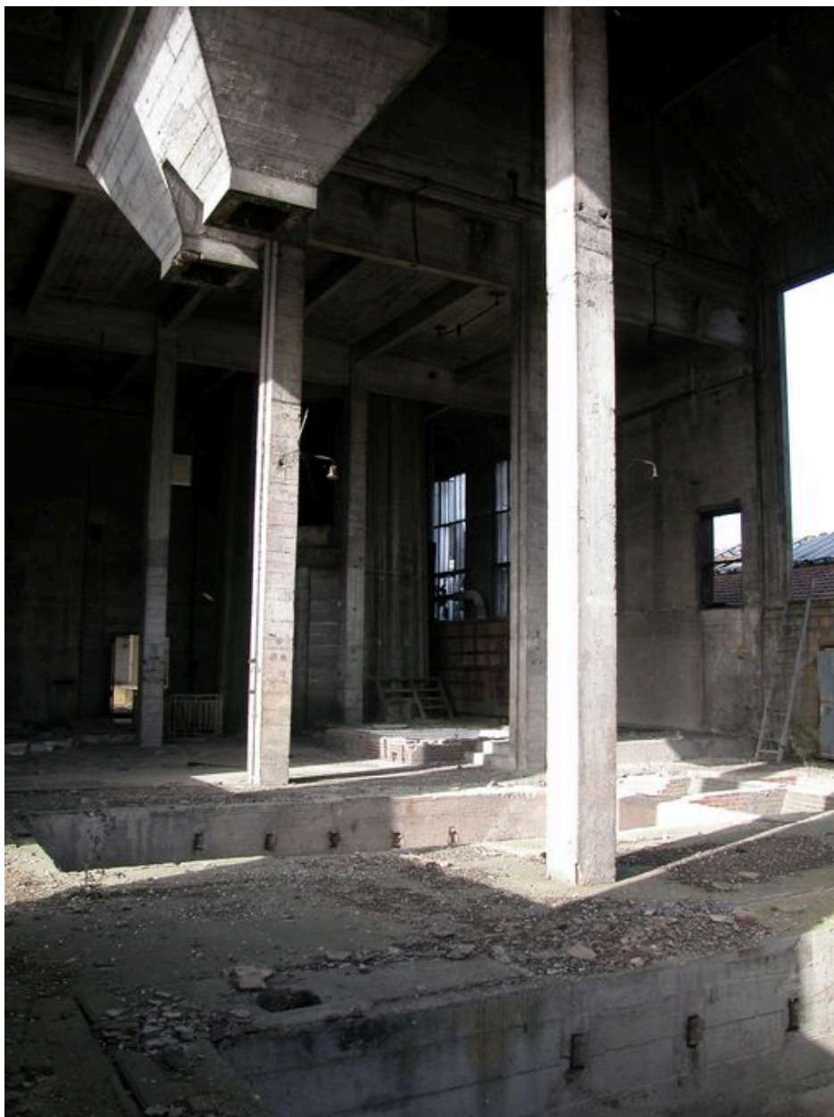
Intérieur du premier étage de la chaufferie.
