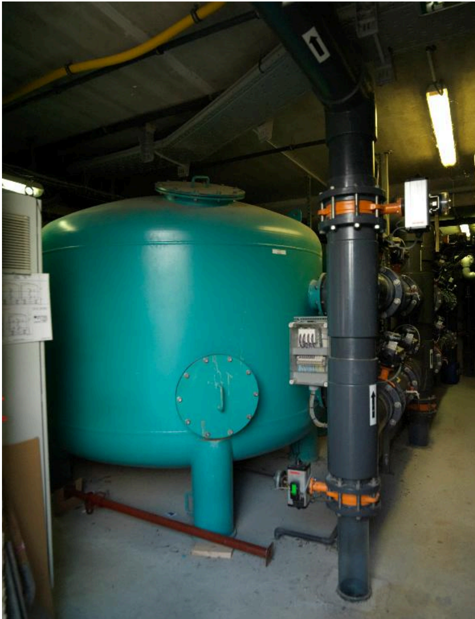
Local technique : cuve de filtration.
