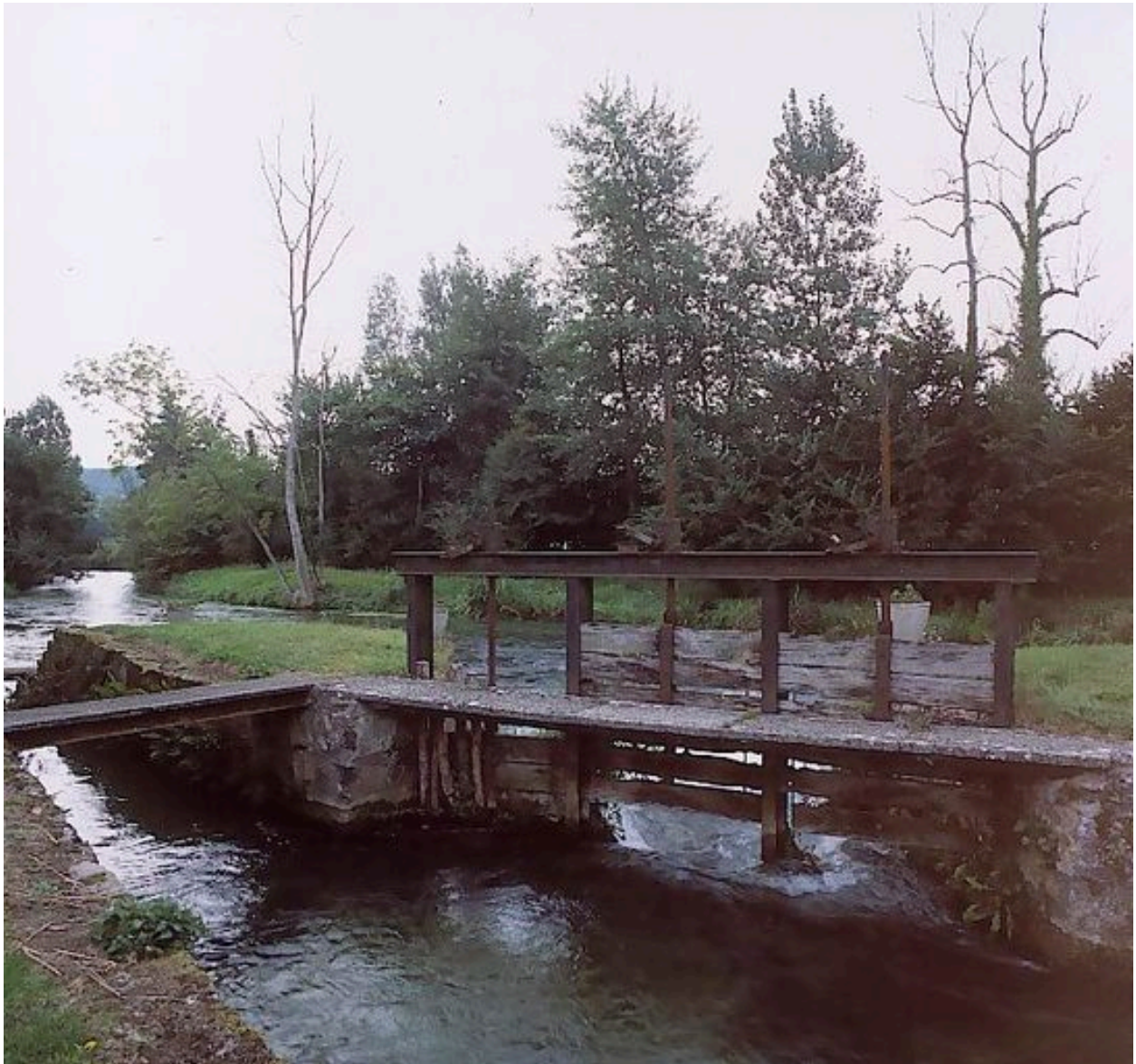
Le vannage de décharge.
