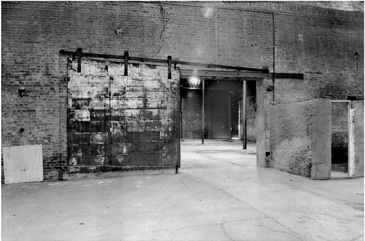
Entrepôt industriel. Vue intérieure. Porte inifugée.
