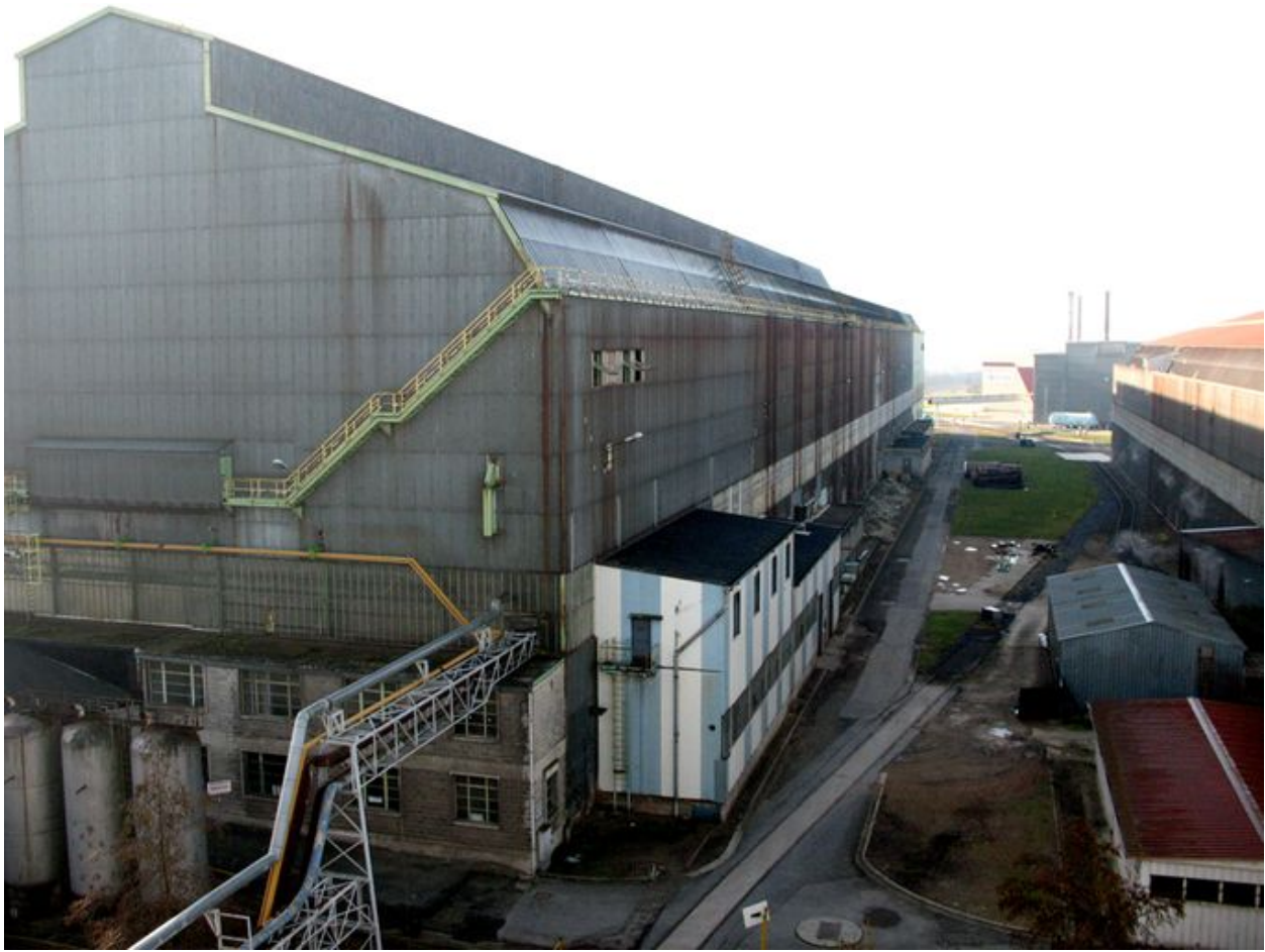
Atelier de stockage et rails.
