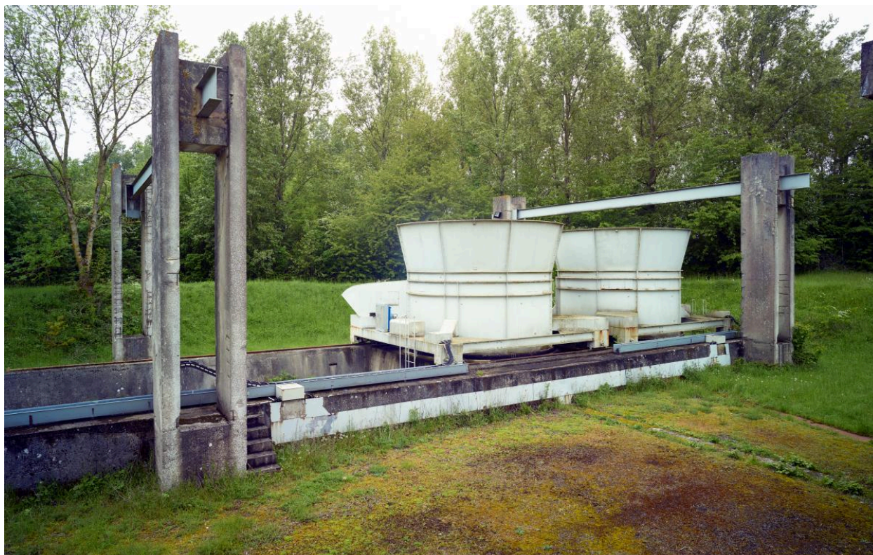
Turbines de ventilation et rails de maintenance. Vue depuis la plate-forme du poste de commande.
