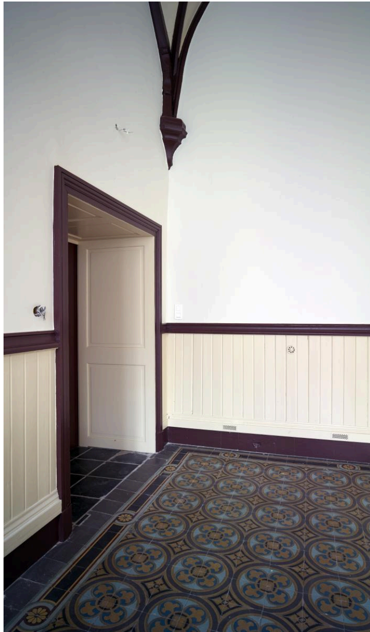
Salle du rez-de-chaussée de la chapelle, ancien réfectoire des élèves. Détail du décor de carreaux de ciment du sol.
