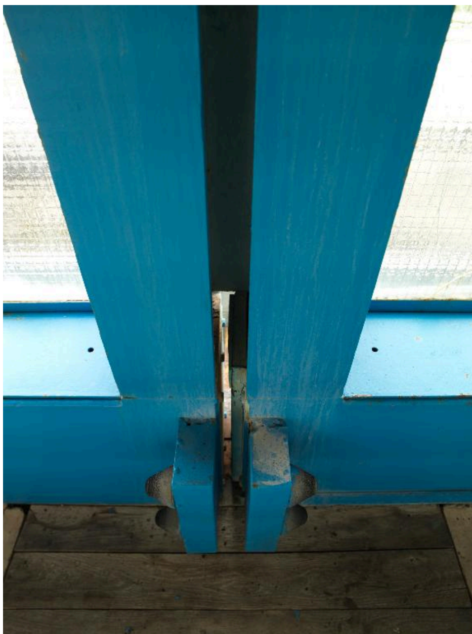
Détail de la jointure entre les deux parties de la structure mobile.
