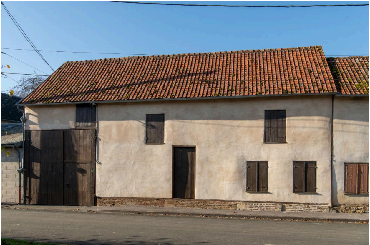
Ancienne habitation d'artisan avec grange et atelier (?) sur rue, n°12 rue de l'Abreuvoir, vue depuis l'est.
