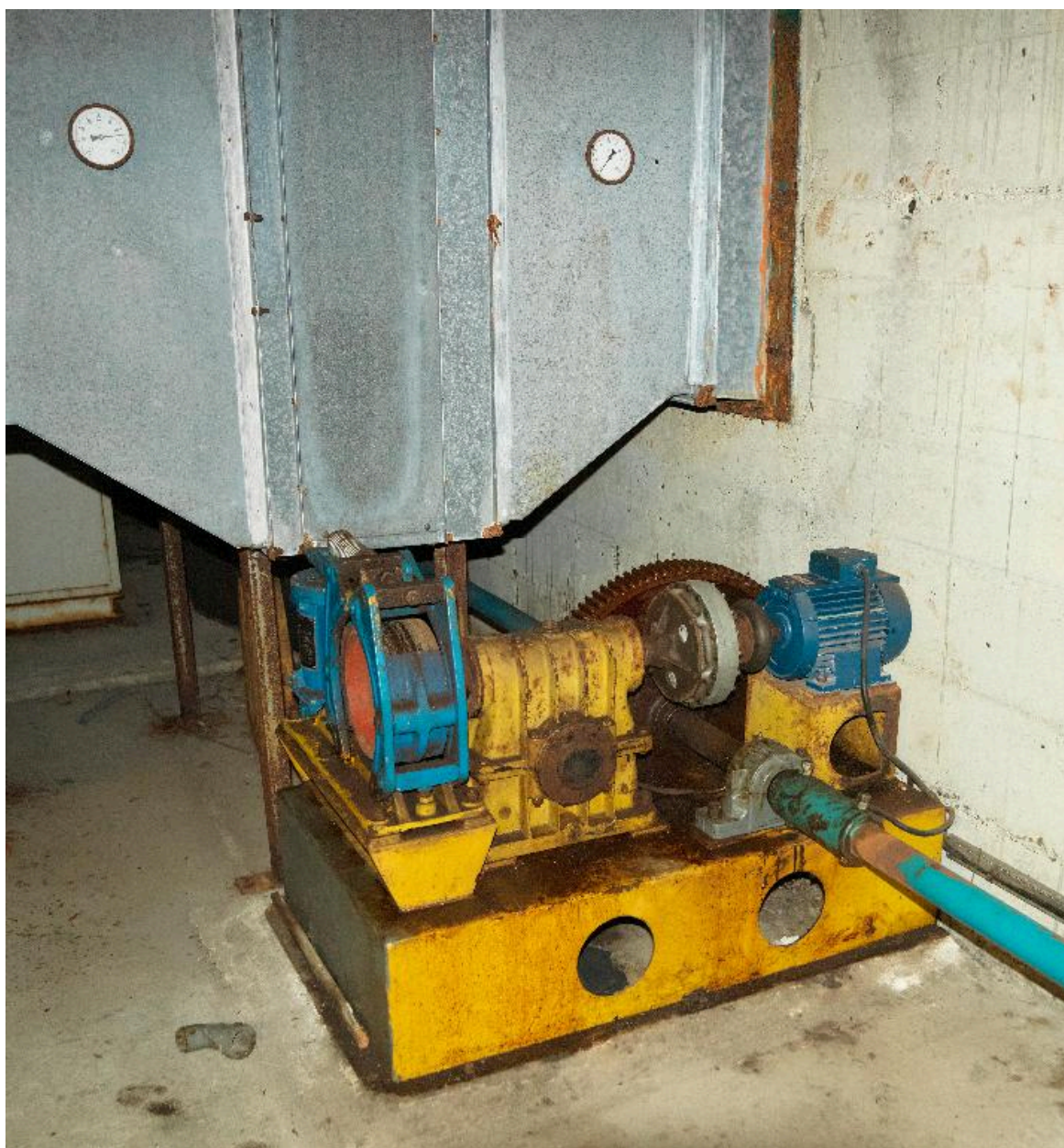
Moteur de la structure mobile.
