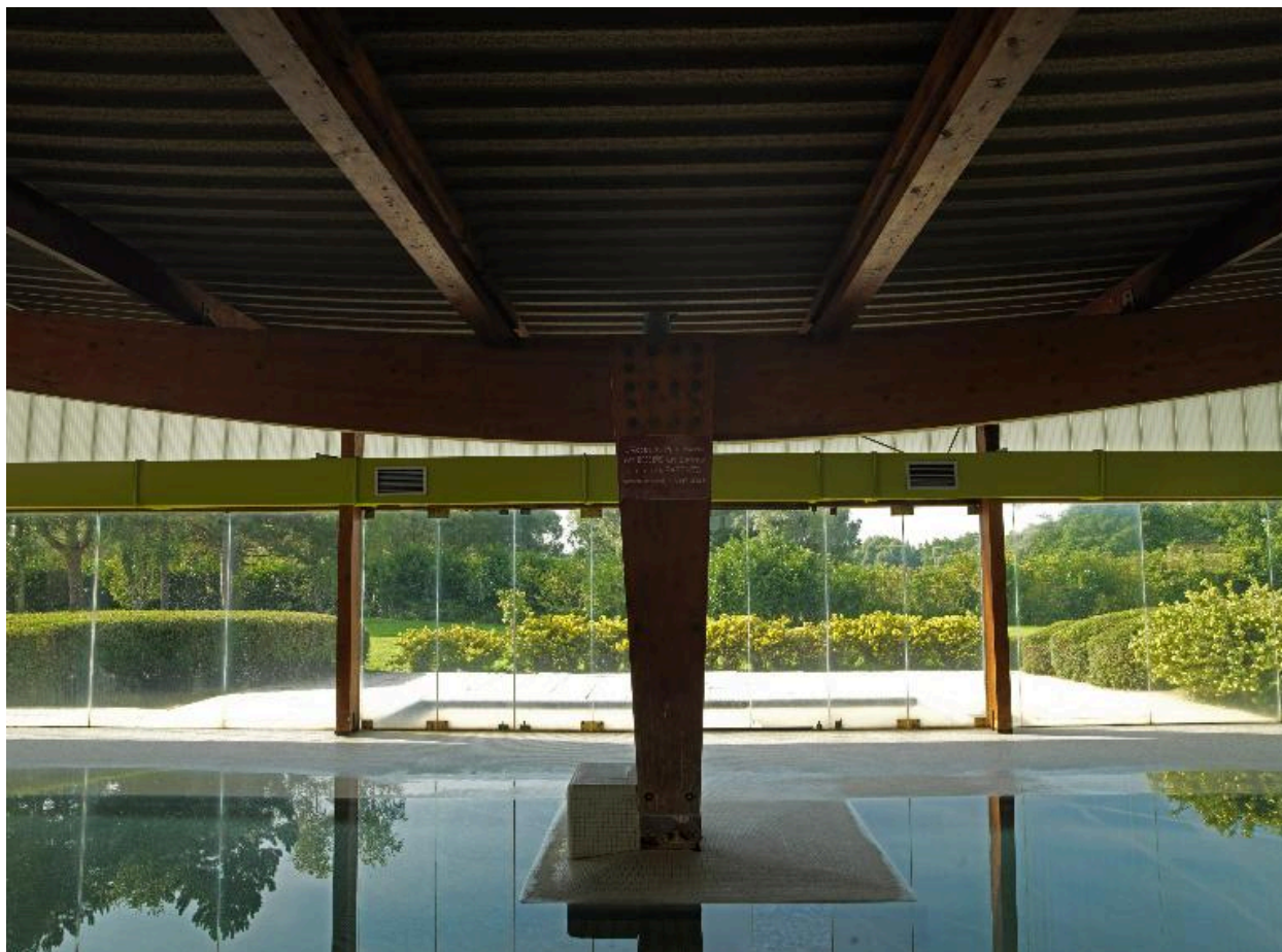
Détail de l'assemblage des poutres en bois lamellé-collé au niveau de la pataugeoire.
