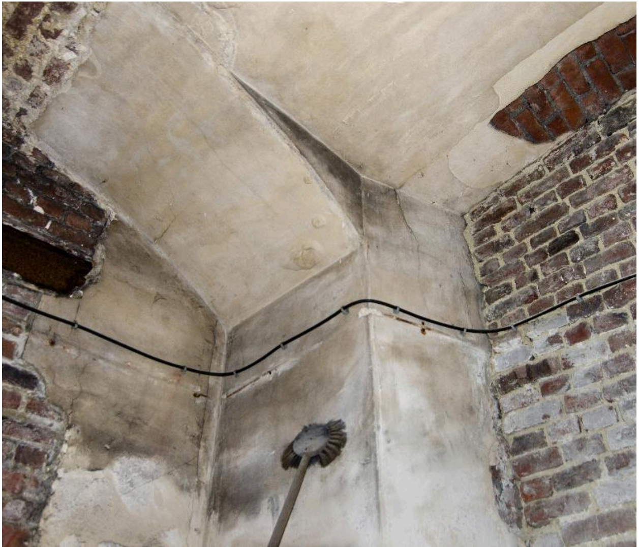
Bâtiment du dépôt, sous-sol : détail d'un pilier de fondation et d'un arc porteur.
