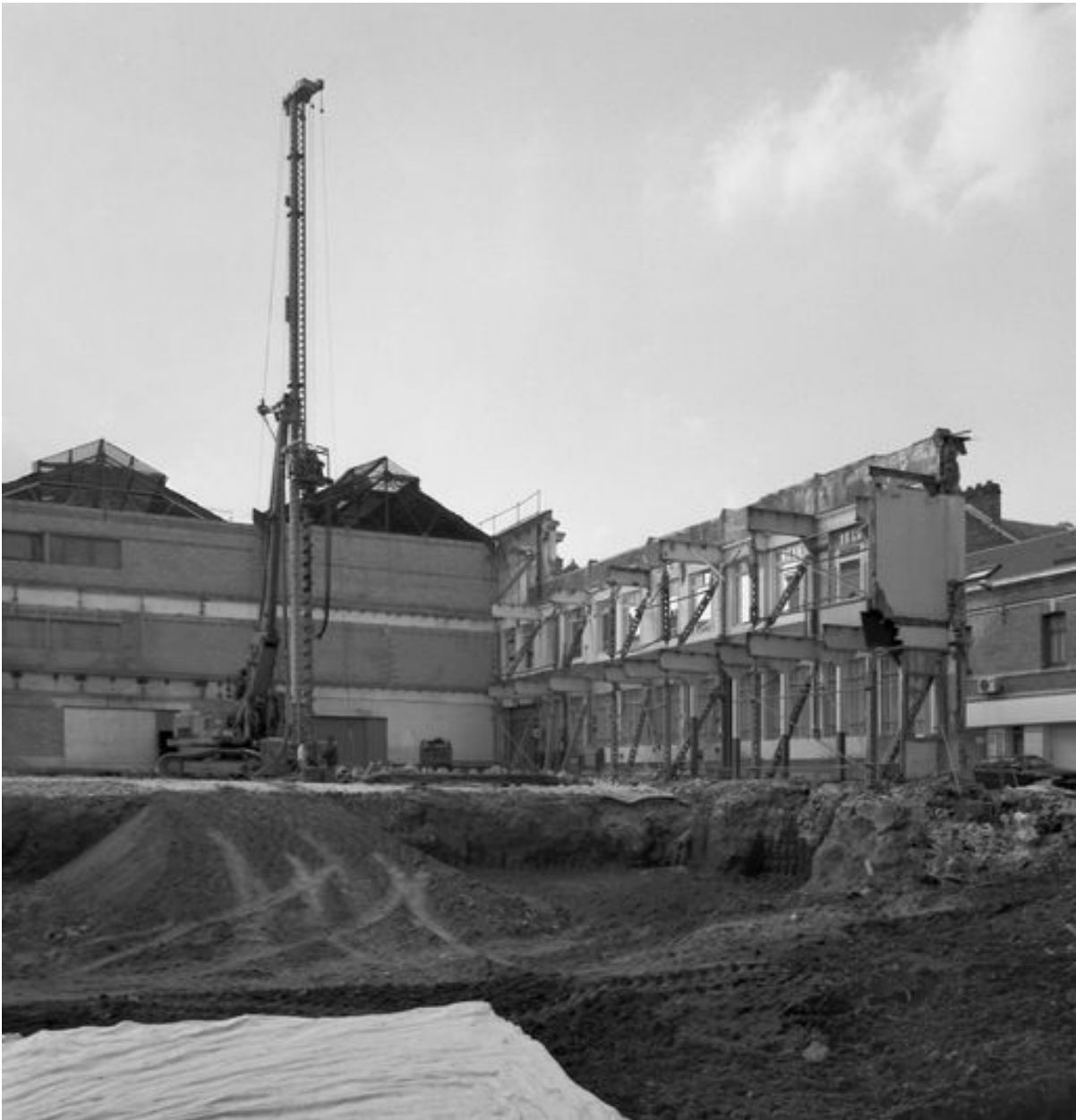
Vue des travaux de destruction du garage Gueudet ne conservant que la façade latérale.
