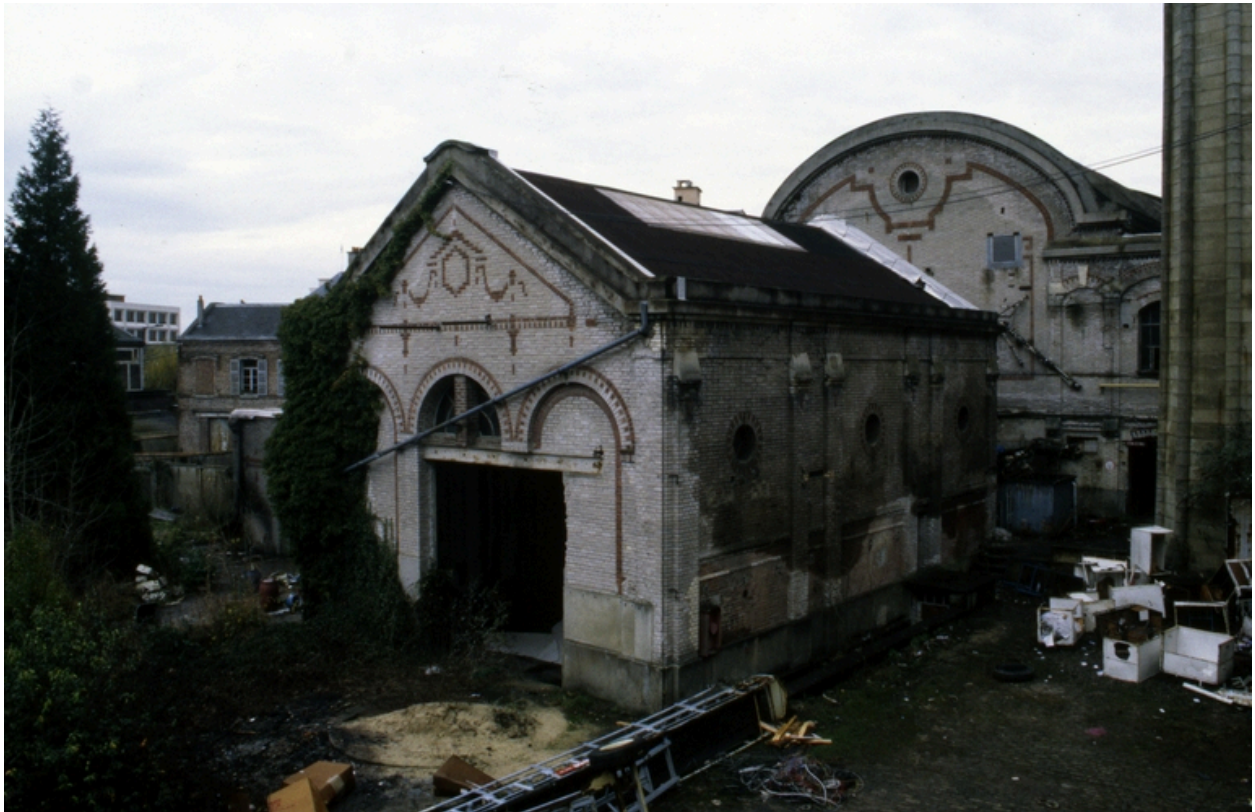
Vue d'ensemble de la chaufferie, 2001.
