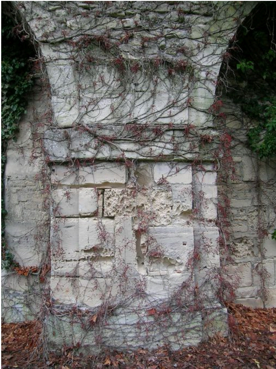
Détail des soubassements endommagés.
